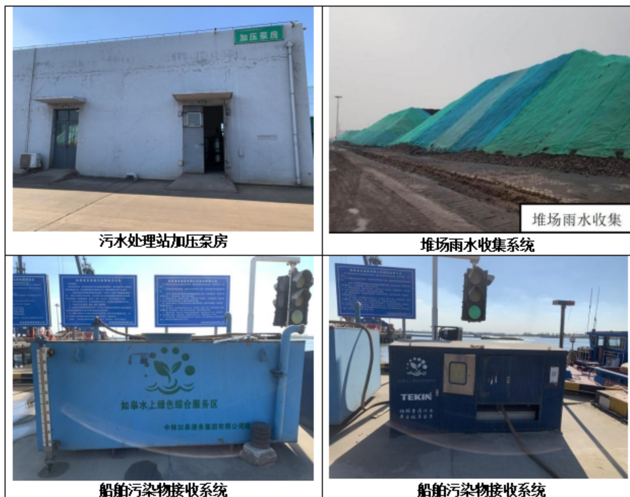
图 3.8-4 港区现有污水处理站、雨水收集措施
